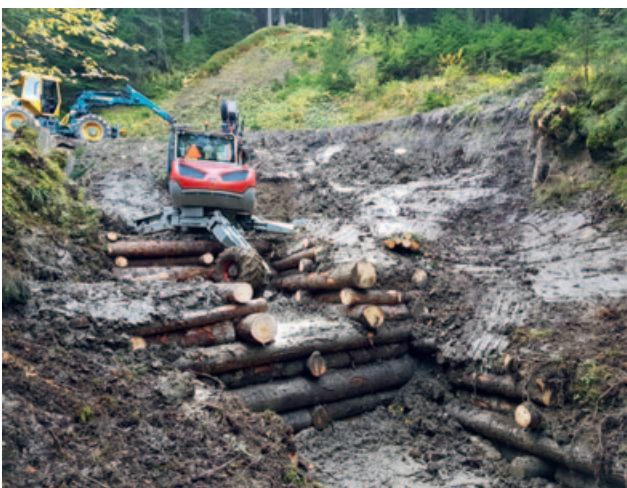
Rutsch hinter Teifibach mit Holzkastenverbau im Bachgerinne
