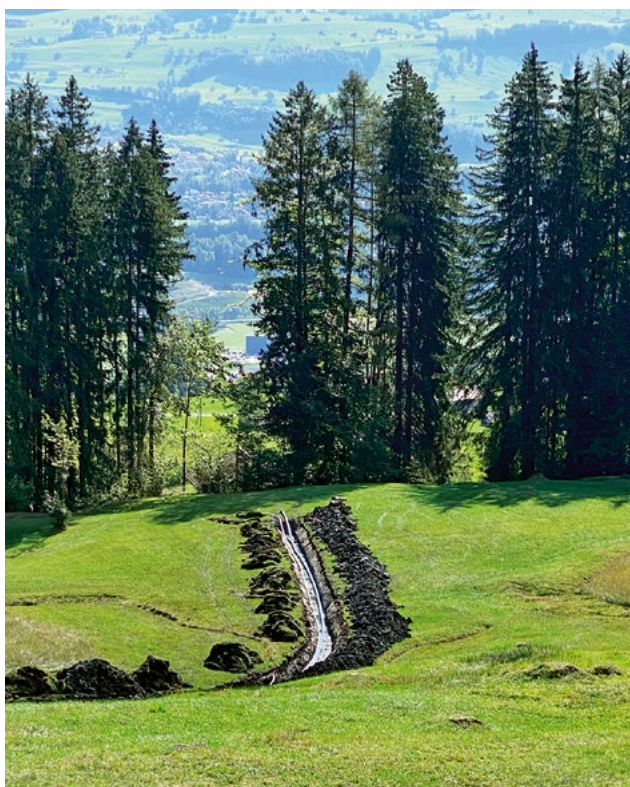
Wasserleitungen Quelfassung Gärtli
