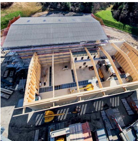
Heizzentrale Wärmeverbund Sarnen
