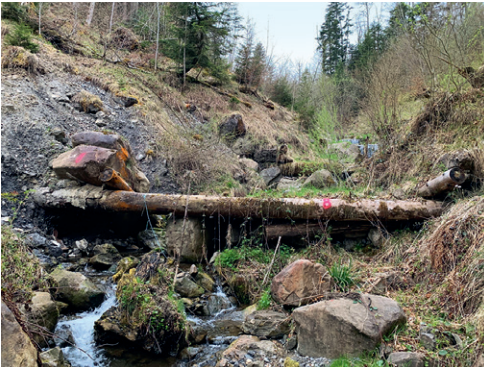
Ausgespülte Schwelle mit seitlicher Erosion
